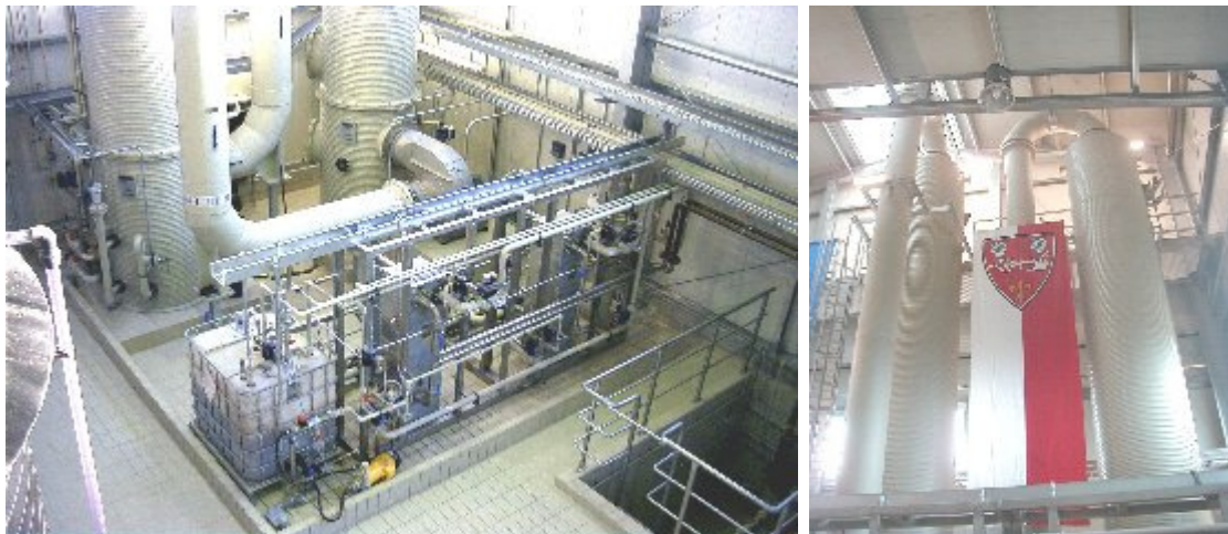
Abbildung 3: Strippung / saure Wäsche am Beispiel des Klärwerkes der Stadt Straubing
